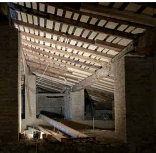
8 e 9. La struttura del tetto rammentata.
