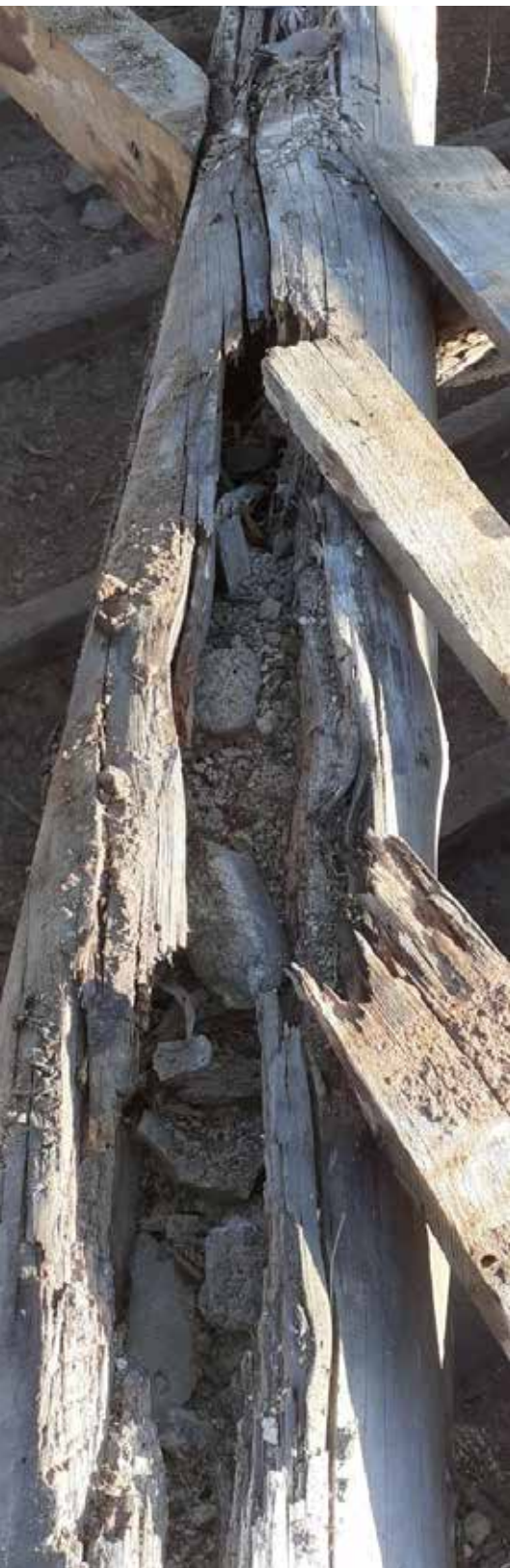
4. Degrado di una trave lignea di copertura
