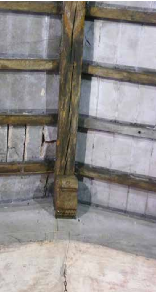
2. Il degrado della copertura: rottura delle tavelle in cotto.
